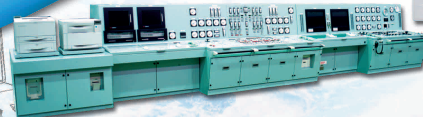
エンジンコントロールコンソール
