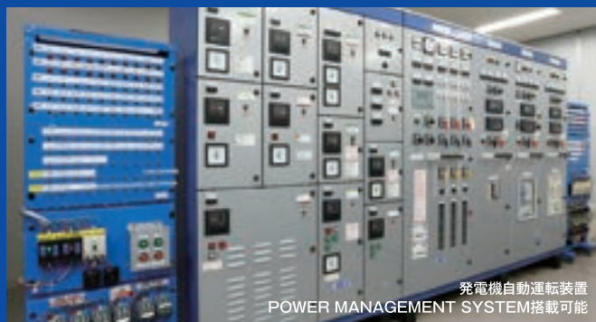
低圧配電盤シミュレータ
